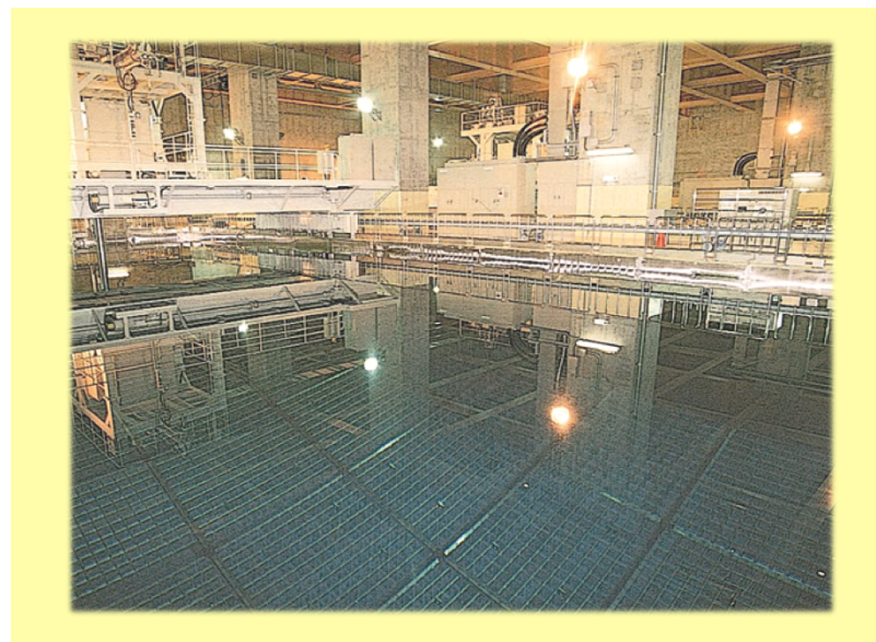
日本原燃(株) 使用済燃料貯蔵プール
