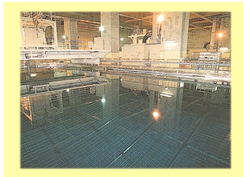
日本原燃(株) 使用済燃料貯蔵プール
