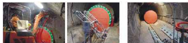
機械的除去 流体的除去 PEMの回収 廃棄体回収作業の例
